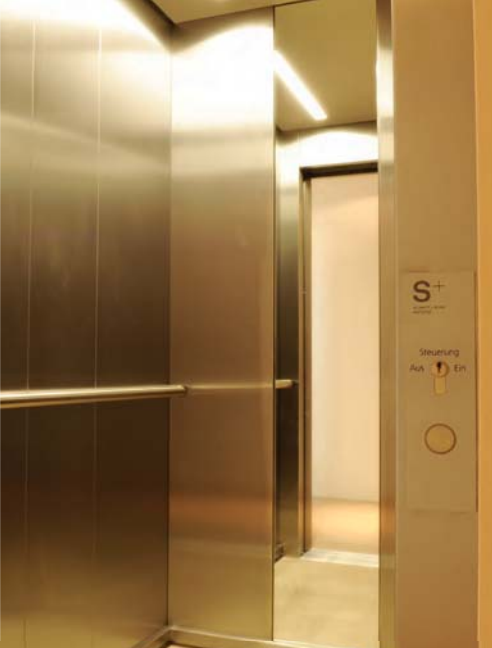
moderne Aufzugsanlagen gewährleisten Barrierefreiheit
