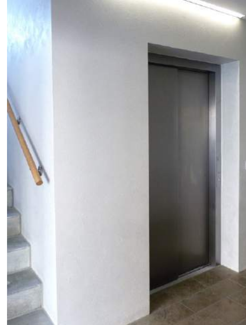
moderne Aufzugsanlagen gewährleisten Barrierefreiheit
